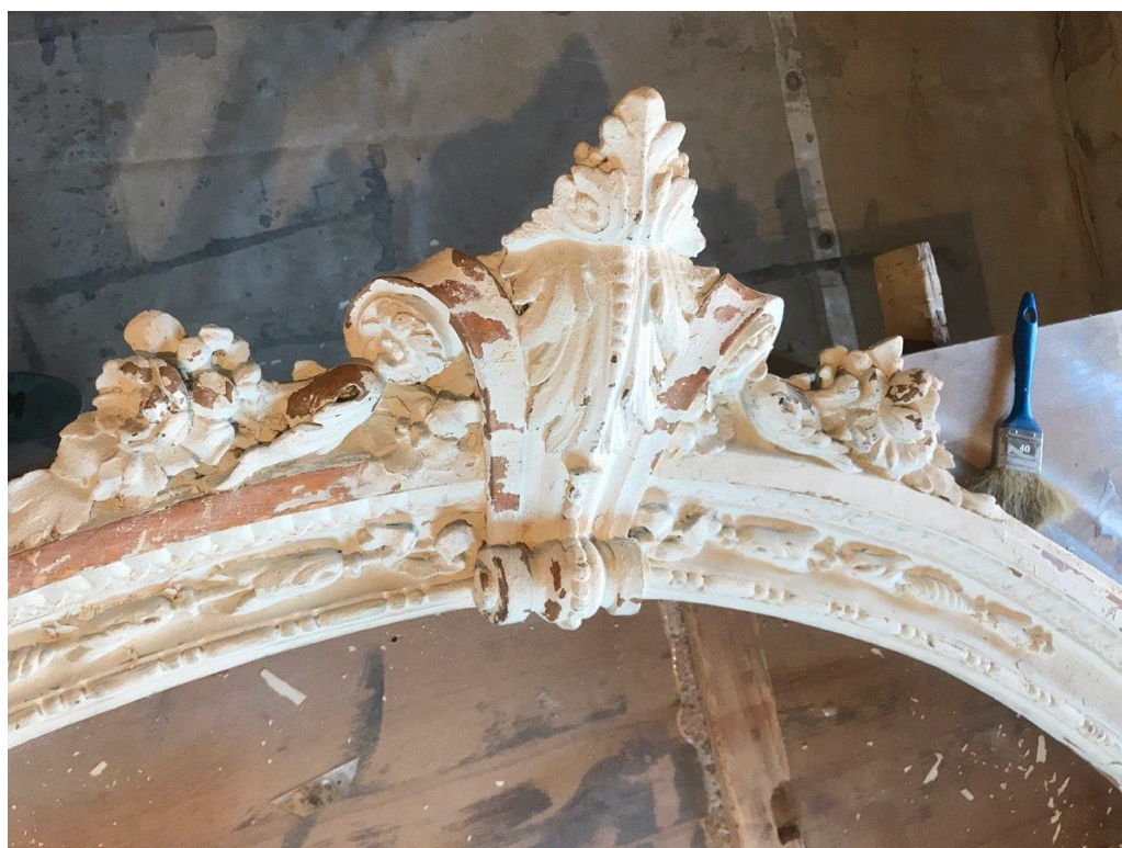
Іл. 22. Фрагмент віконного карнизу «Білої зали» до реставрації.
