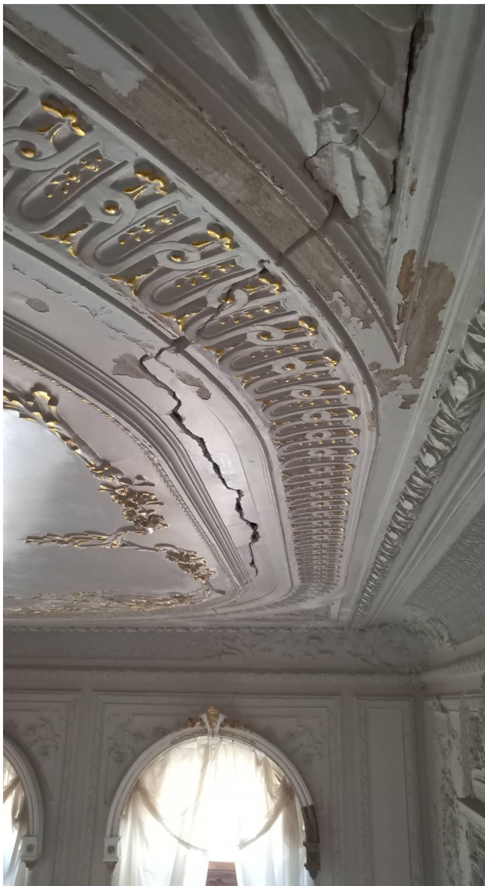
Іл. 25. Фотофіксація реставрації тріщини на стелі «Білої зали».
