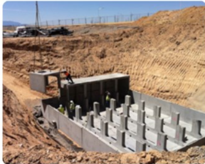
Підземний резервуар дощової води.
